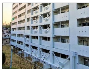
リフォーム事業 ぐみさわ東ハイツ (戸塚区) 耐震補強工事
